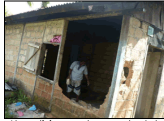
Kondisi rumah penduduk yang terkena gempa
