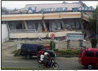
Kondisi Hotel Mutiara setelah gempa
